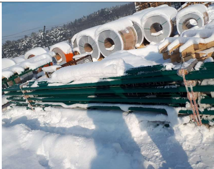
Nieprawidłowe składowanie materiału. Materiał pokryty śniegiem i narażony na działanie skrajnie niekorzystnych warunków atmosferycznych.
